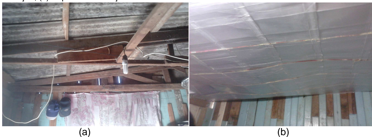
Figura 1 - Fotografia de uma das residências onde os painéis foram instalados. (a) Antes da instalação; (b) Depois da instalação.
